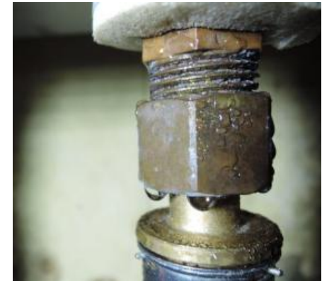
水道配管ジョイント
